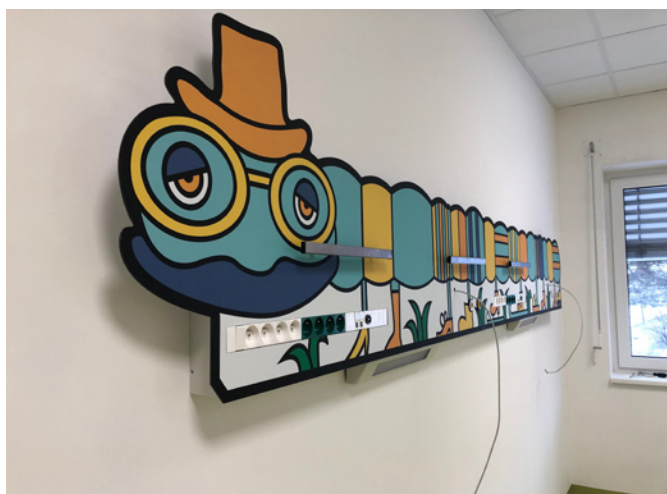
Tahle housenka v sobě skrývá všechny rozvody a přívody, které jsou na nemocničním pokoji potřeba.
